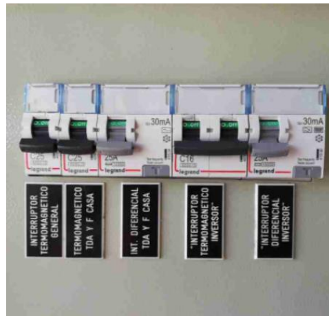
Figura 11-10 Rotulado de protecciones.
