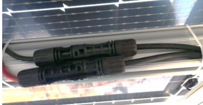
Figura 11-2 Conectores MC4 correctamente instalados y fijados.
